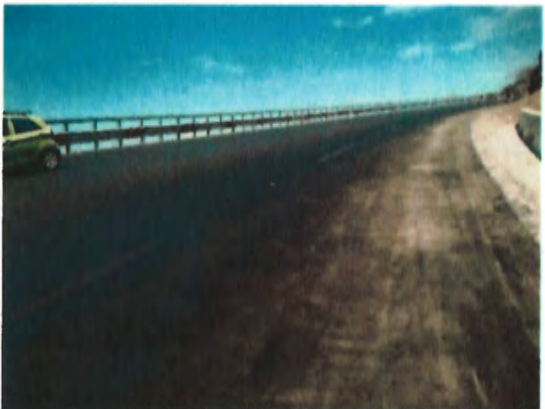
Limpieza de derrame de aceite Km 048+900 Piura Paita
